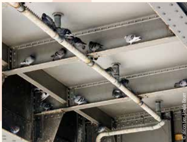
Armseliges Wohnen unter der Brücke.
